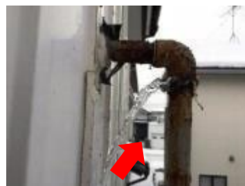
給水管がむき出しになっている
