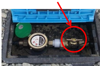
メータボックス内の止水栓の例
