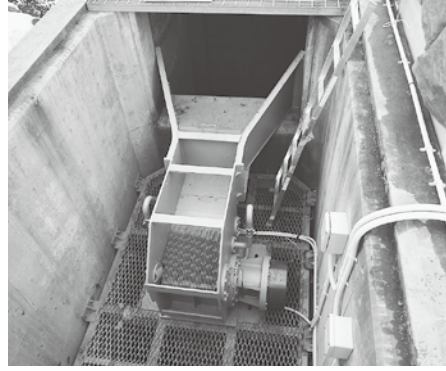
雑水山小水力発電所
