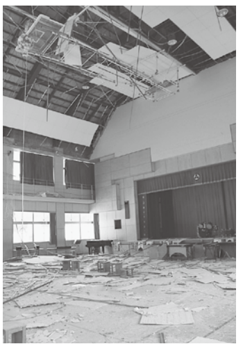
被災の大きい小学校体育館
