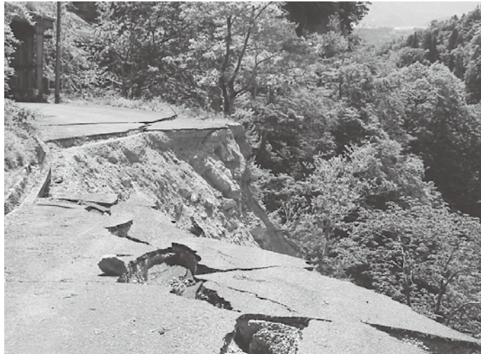
被害写真(道路崩落)
