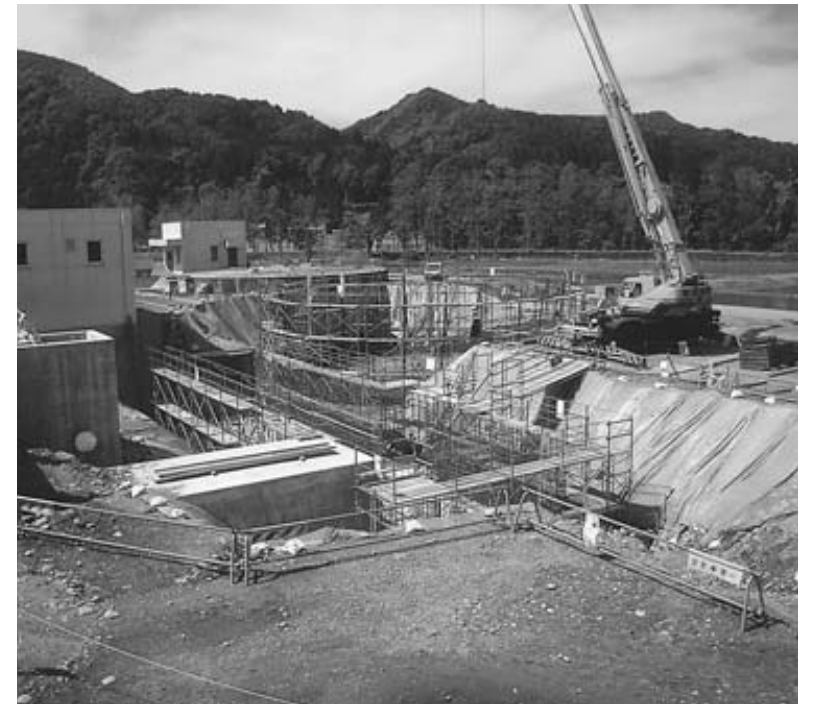
下島浄化センター工事
